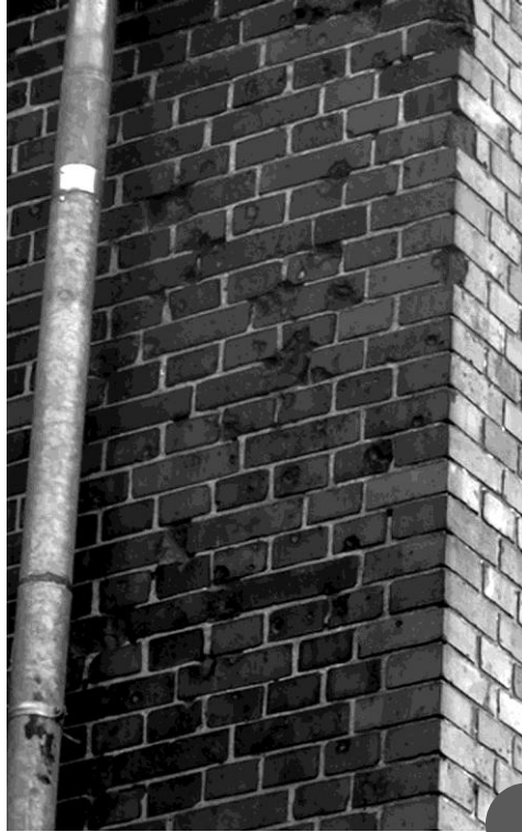
Ślady po kulach na budynku szkoły zachowały się do dziś
